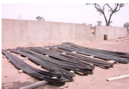
Figure 14 : Stockage des matériaux à l'air libre
