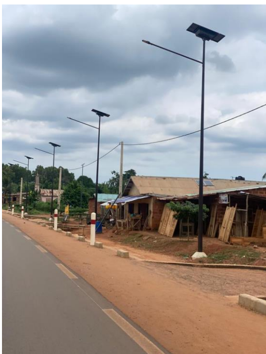
Photo 10 : Lampadaire solaire à un bras, Tori – Bénin
