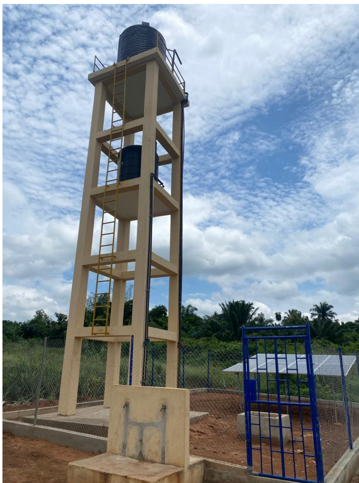
Photo 7 : Système de pompage solaire, Tori – bénin
