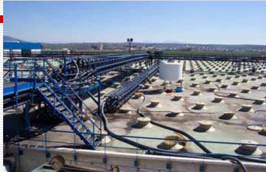
Conduites pour le transport des olives dans leur saumure
